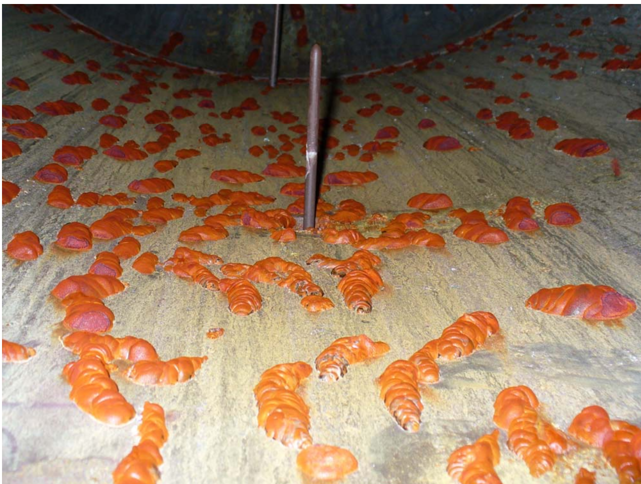
FIG. 12: CONCREZIONI CON BIOFILM IN SERBATOIO IDRICO
