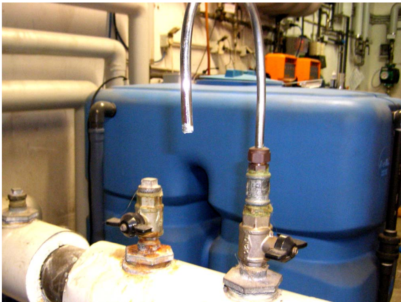
FIG. 21: CORROSIONI DA CONTATTO
