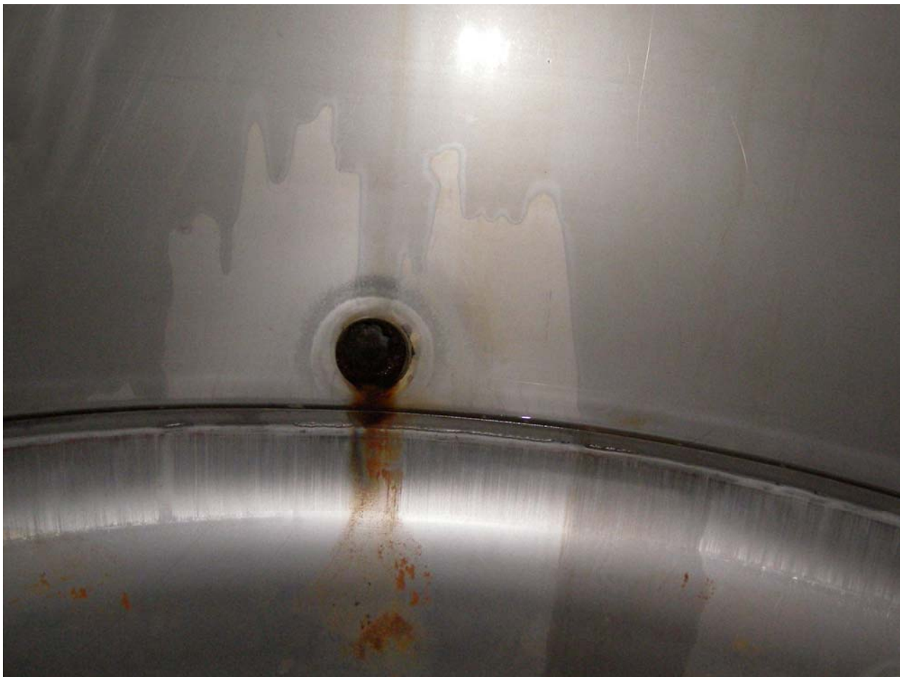
FIG. 22: EVIDENTE CORROSIONE ALL'INTERNO DI UN BOILER IN ACCIAIO DOPO POCHE SETTIMANE DI ESERCIZIO
