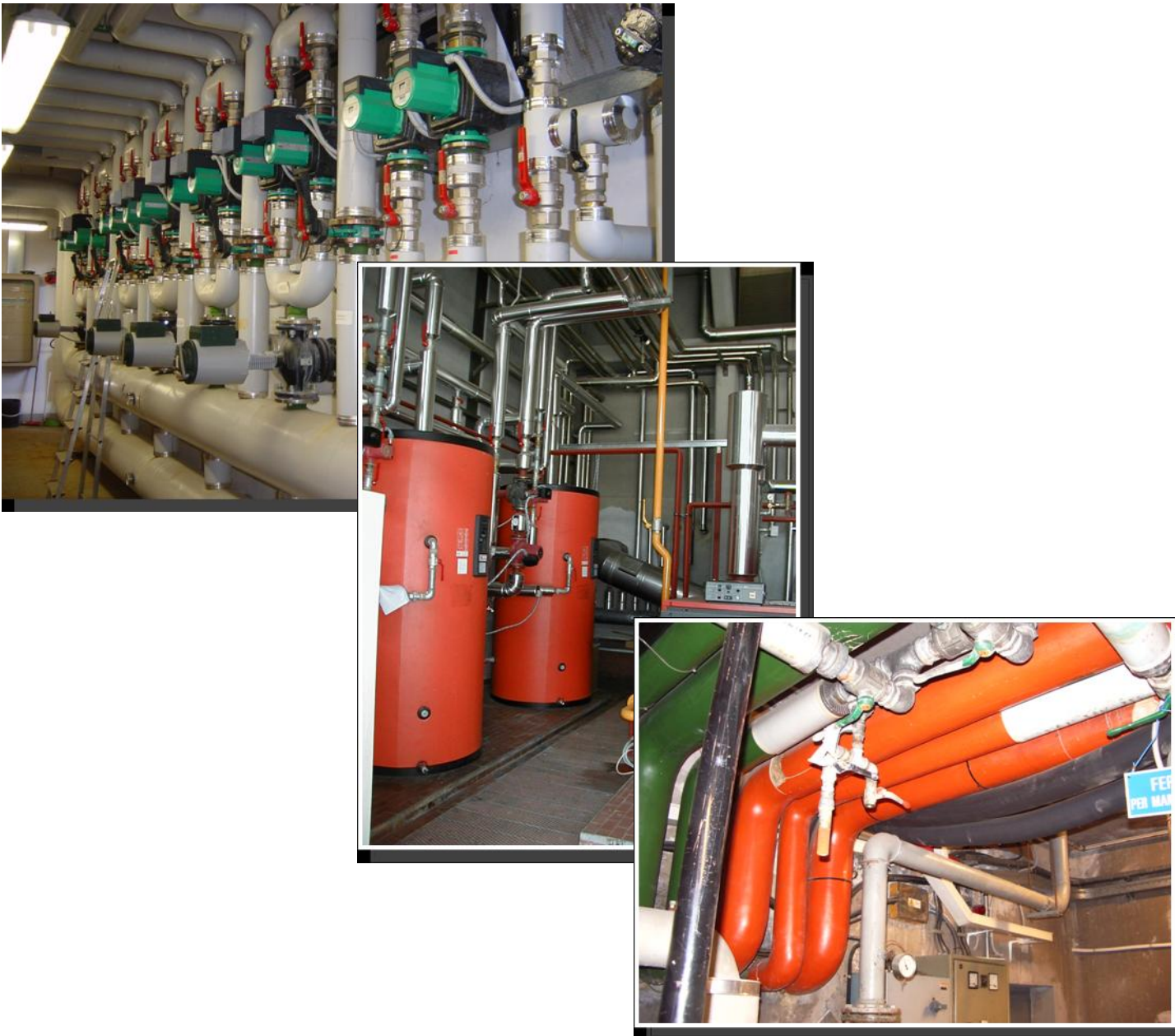
FIG. 13: CRITICITA' NEGLI IMPIANTI IDRAULICI
