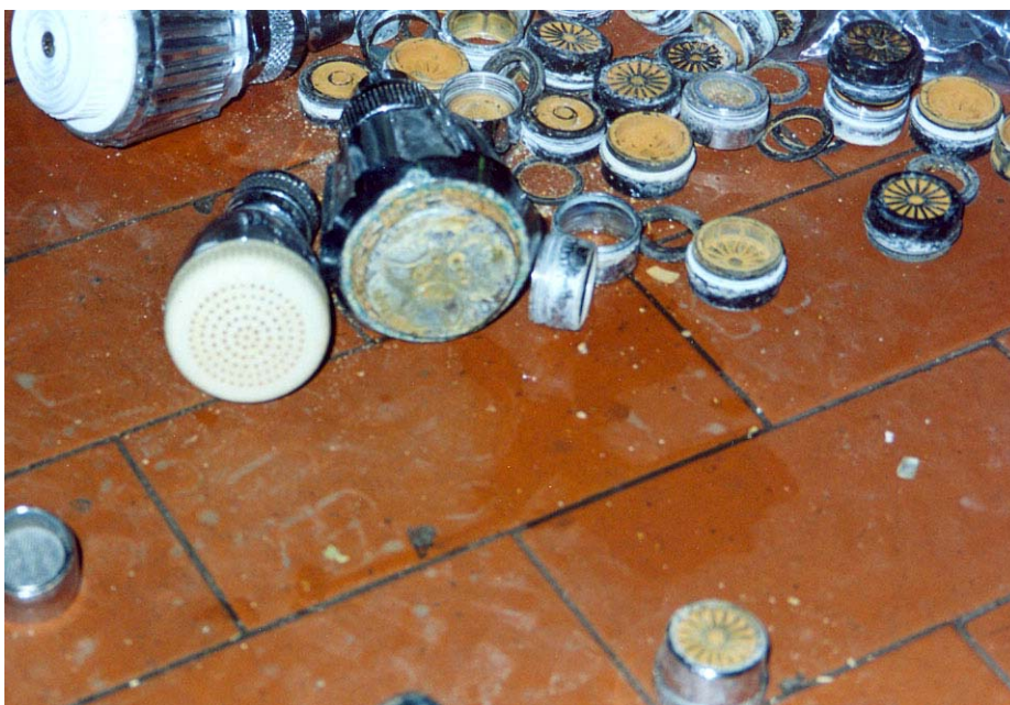
FIG. 15: CRITICITA’ NEGLI IMPIANTI TERMINALI
